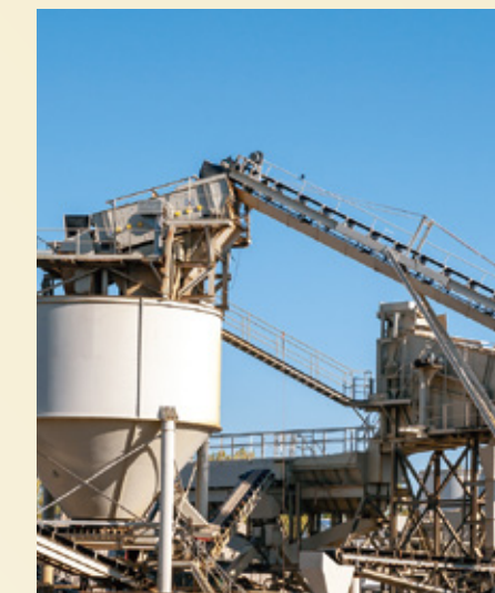
■コンクリートプラントのベルトコンベア
